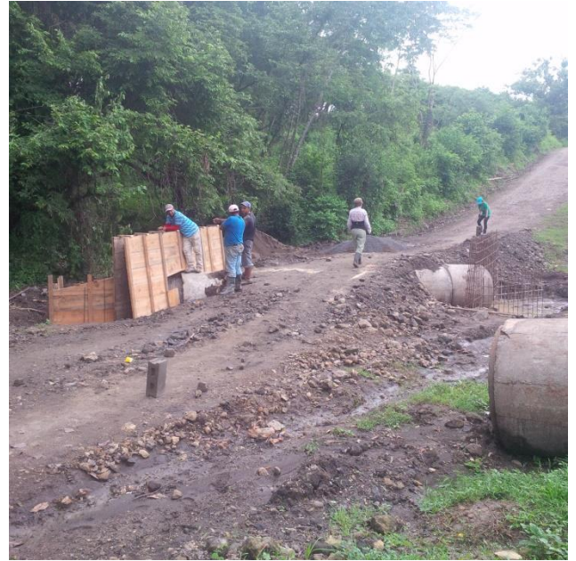
Travaux de canalisation dans la comunidad (route qui sera prolongée jusqu'au Costa Rica)
